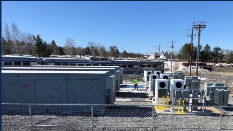
Regulación de Frecuencia / Servicios Auxiliares – VT, USA
