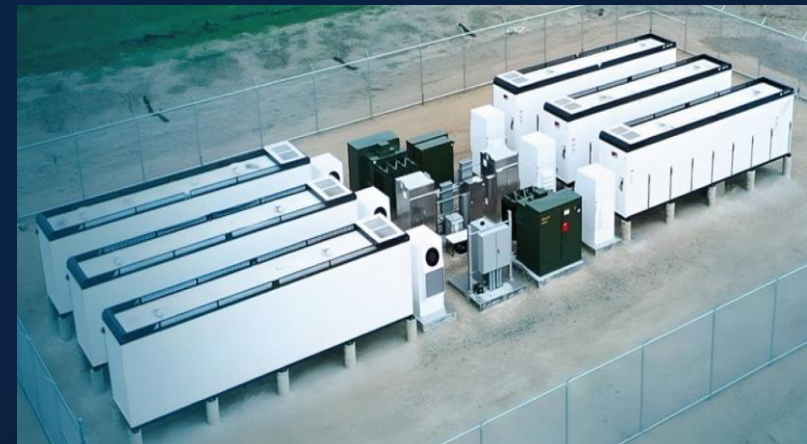
Regulación de Frecuencia / Servicios Auxiliares – WI, USA
